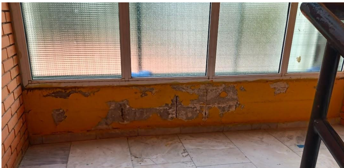
Υγρασίες – σαθρά υλικά
